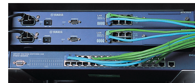
マシンルームに設置されている ヤマハルーターRTX2000(上) およびRT56(右)
