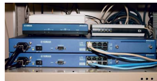
情報システム部(横浜)に設置されたRTX2000とRTX1000
