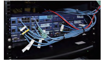
サーバーラックは免震構造
