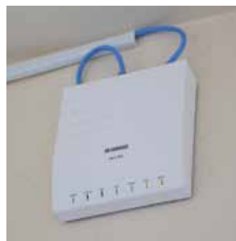
校舎内の廊下での設置写真
