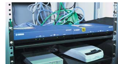
大阪本社に設置されているRTX1000
